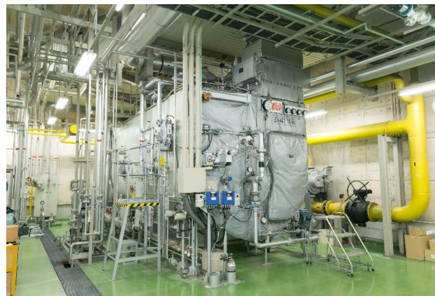
炉筒煙管ボイラ (B4)
