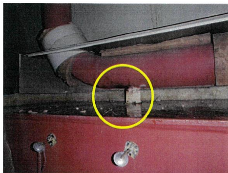
故障： 亀裂箇所
