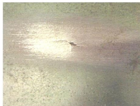
故障： 亀裂箇所（拡大）
