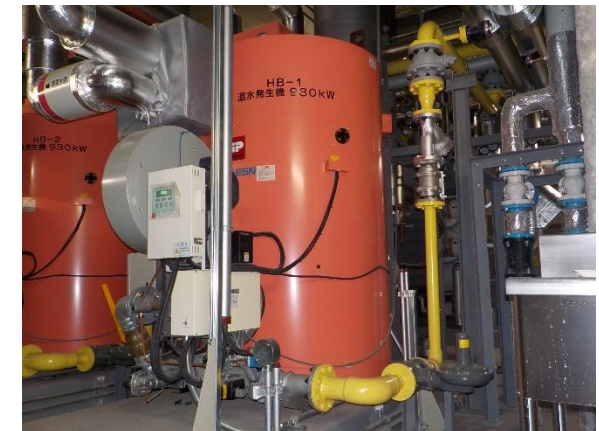
温水ボイラー
