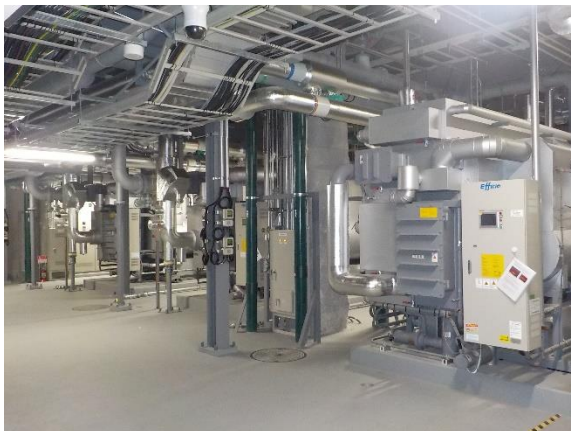
吸収冷温水機
