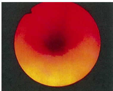
冷却水伝熱管（清掃後） 定期的に清掃し性能維持
