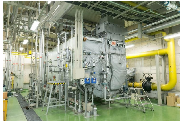
炉筒煙管ボイラ (B4)
