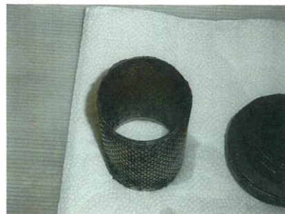
高温再生器 蒸気ドレンストレーナ (顕著な錆なし)
